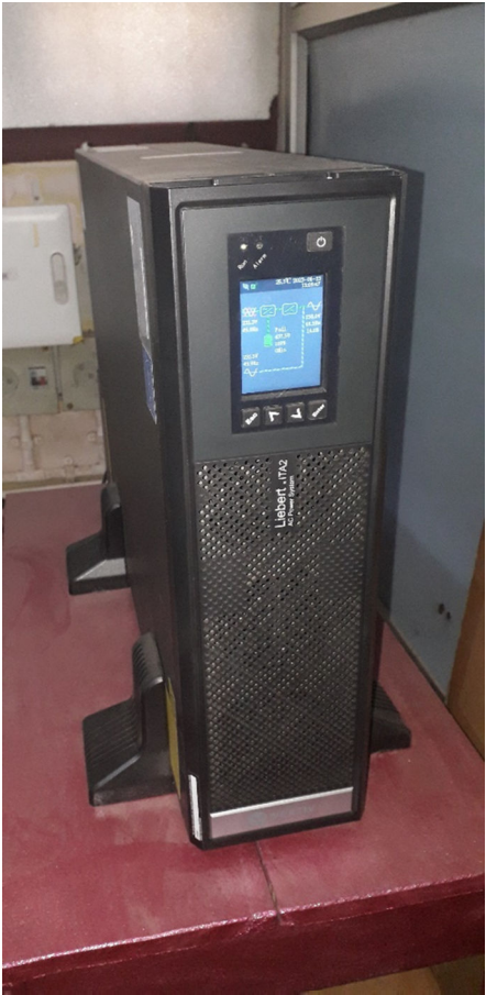
Liebert Vertiv 20kVA
